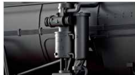
Speisepumpe Bauart VEB BBW KP4-250 mit Peters-Steuerung
